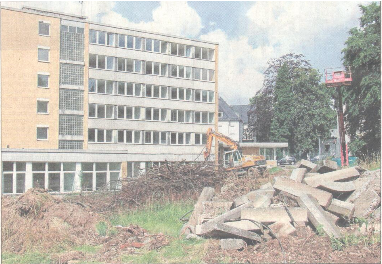
Die „Bereinigung“ des Grundstücks und die Vorbereitungen für Abriss und Neubau an der Hohfuhstraße haben begonnen. Die nächsten Monate werden zur Geduldsprobe für die Anlieger, auch am Heckengang oder Sonnenhang. ■ Fotos: Moos
