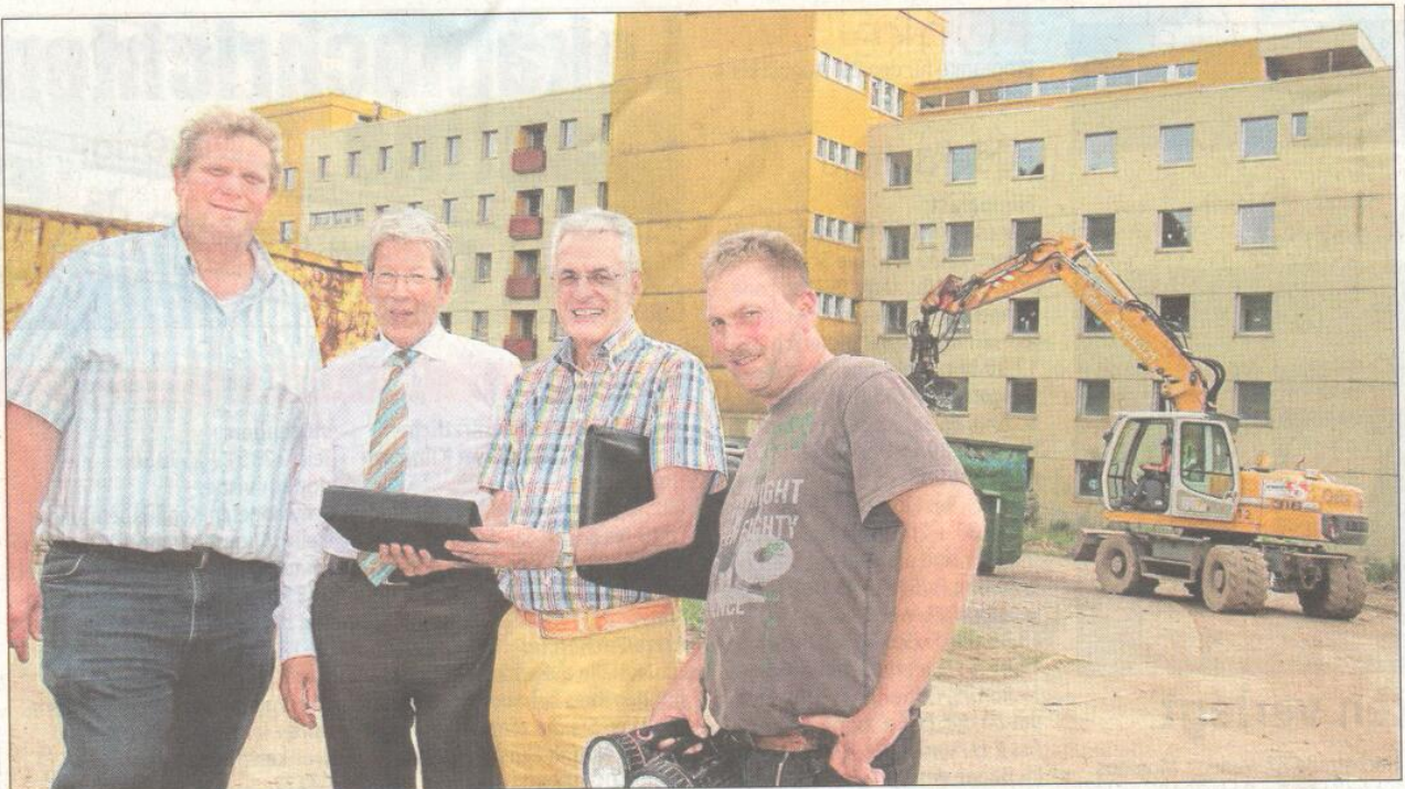
Auf der Baustelle vor dem Gebäude der Kinderklinik: (v.l.) Bauleiter Markus Diederich, Projektentwickler Roland Rothmann, Marketing-Chef Willi Denecke und Schachtmeister Jörg Schnell. • Foto: Nougirgat
